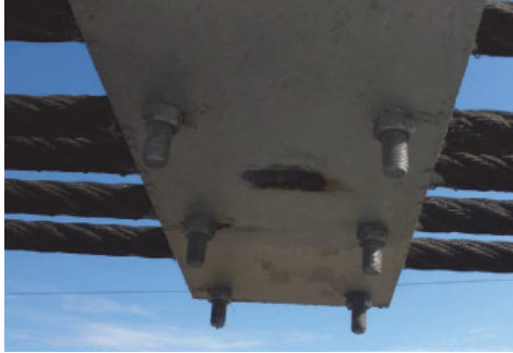
Figura 6.2. Corrosión del agujero en el herraje del pendolón
